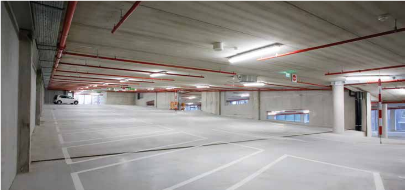
De parkeergarage, feitelijk de fundering van het appartementencomplex, heeft drie draaglijnen h.o.h. 15,30 m. Daartussen overspannen kanaalplaatvloeren.
